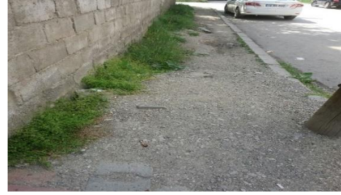
Fotoğraf 5: Yaya Kaldırımı Bozuk Zemin Yapısı Örneği
